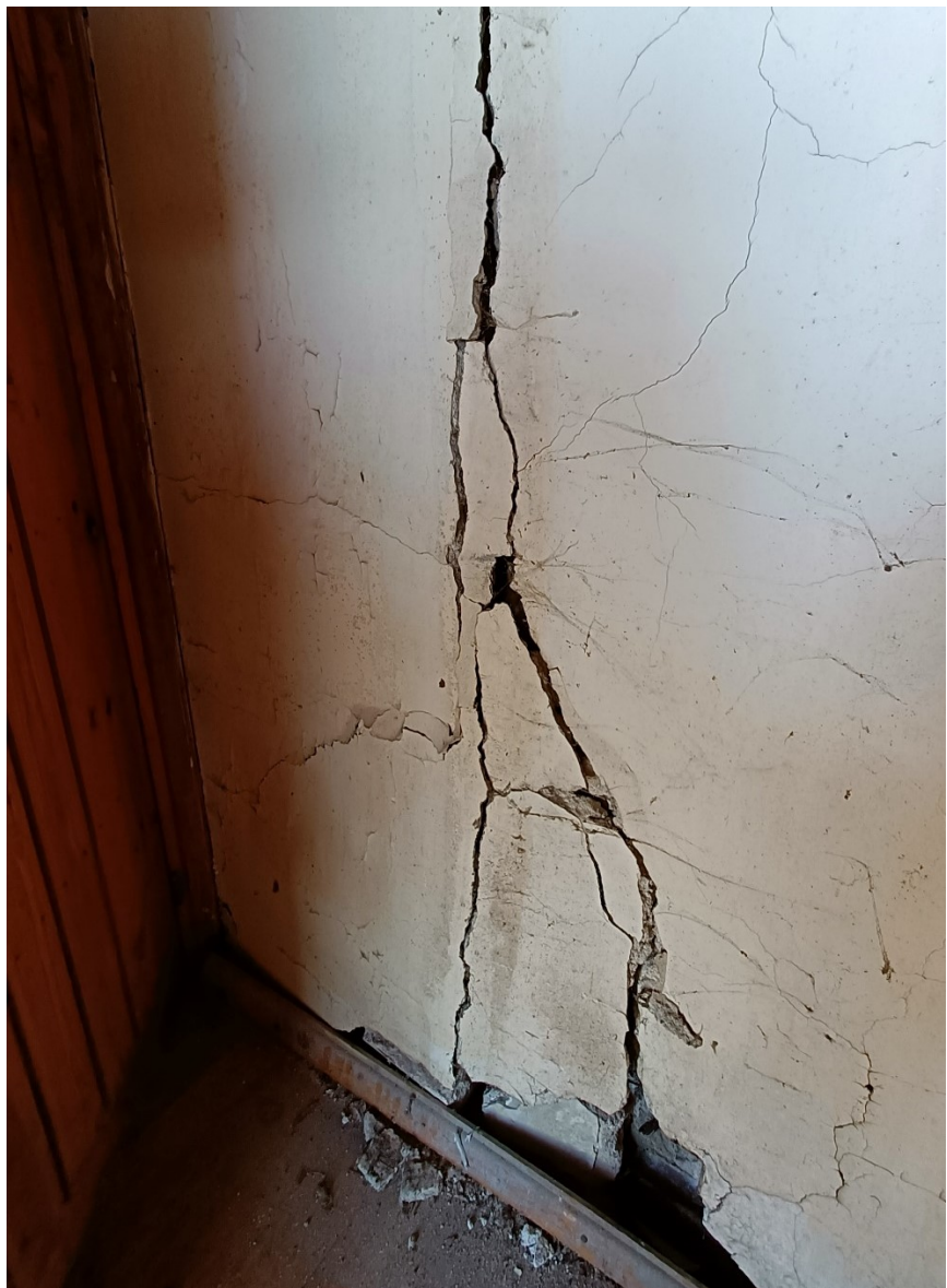
Kuva 7. Hormin ja eteisen ja pukuhuoneen väliseinän välinen halkeama. © Tampereen kaupunki 2025
